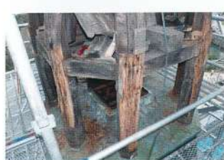
写真11 尖塔飾り木造下地の腐食状況(2009-2010年の修理工事時点)
