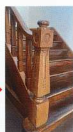
写真9 中央階段手摺の条溝部分
