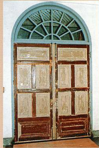
7 工事に発見された扉の当初の木目塗り(薄い色の鏡板の部分は明治村に移築した時の後補材)
