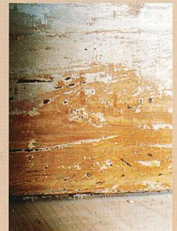
2 工事に発見された幅木の当初の木目塗り(白ペンキの下)黄色系の中塗りの上に茶系色で木目を出す。
