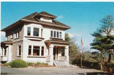
修理前 屋根板は黒ずみ外壁塗装は劣化
