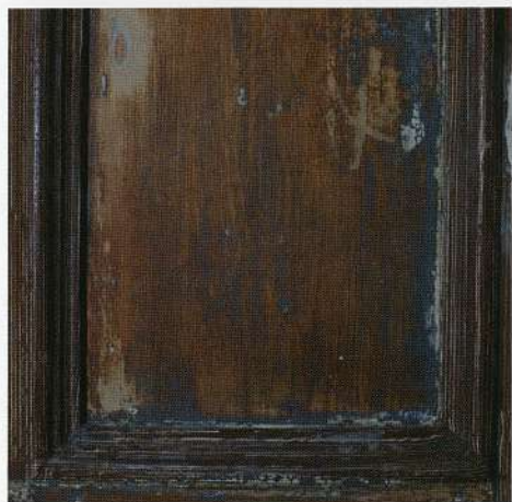
写真7 本館No4室片開扉鏡板 拡大
