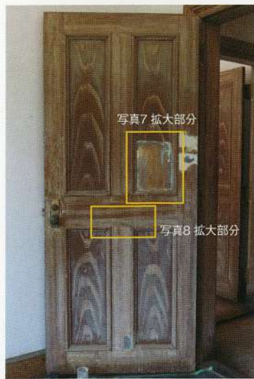
写真6 本館No4室片開扉剥離調査
