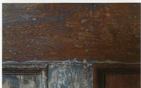
写真8 本館No4室片開扉腰框 拡大
