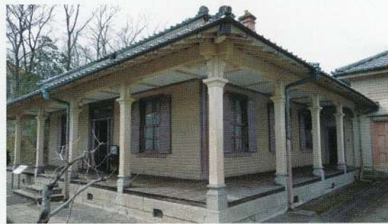
写真2 本館バルコニー（修理前）
