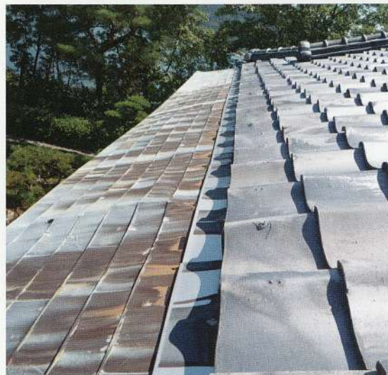
写真2 主屋東側銅板葺劣化状況
