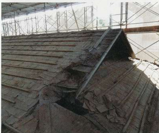
写真7 台所部分屋根下地の劣化状況
