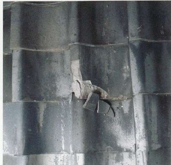
写真4 大屋根の瓦劣化状況詳細
