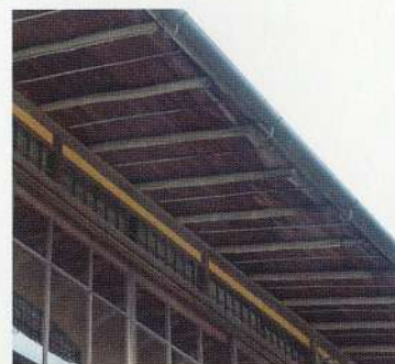
写真3 二階南面庇上裏の劣化
