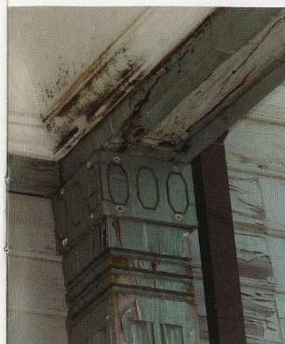
写真2 修理前車寄せ柱及び梁の腐朽
