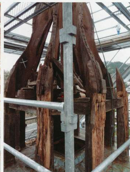
写真3 塔屋解体腐朽状況の確認
