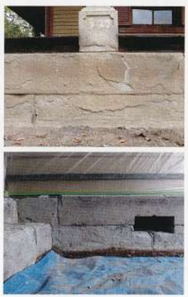
写真6 本館(上)と別館(下)の基礎石の修理前状況
