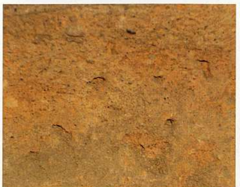
写真6 レンガに発生した空隙(孔)
