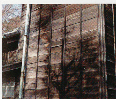
写真3 西面和館下見板の劣化
