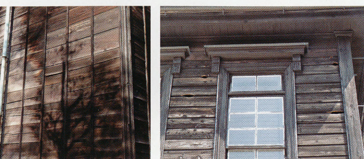
写真2 東面洋館下見板の劣化
