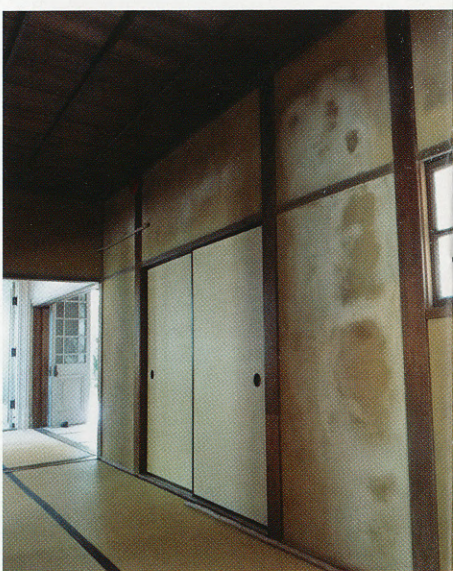
写真4 一階廊下雨漏りによる壁面の劣化
