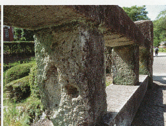
写真2 修理前の表面剥離
