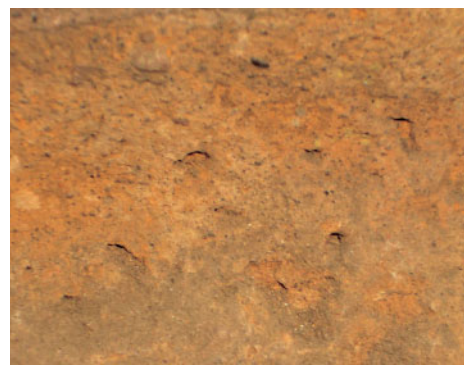
写真6 レンガに発生した空隙（孔）
